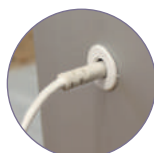
Zabezpieczone wyjście na kabel
